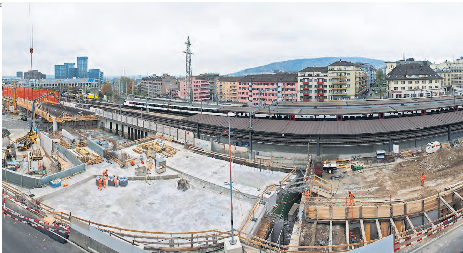
L'importante (in tutti i sensi) cantiere del passante ferroviario di Zurigo (Durchmesserlinie)
