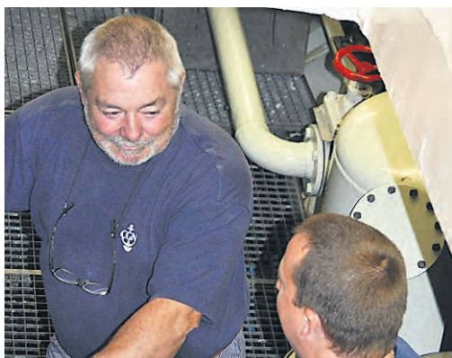
Olivier Mettraux n'est pas seul dans la salle des machines du Rhône . Il est secondé par le sous-machiniste Jean-Pierre Dubouloz, également membre du SEV comme les 99 % du personnel de la CGN.
