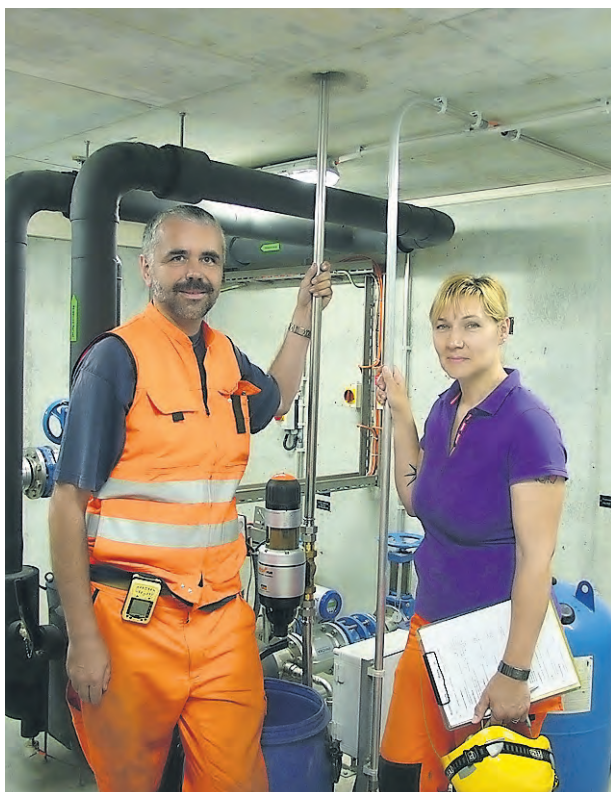
Rolf Allenbach e Evelin Schmid controllano la stazione di pompaggio.
