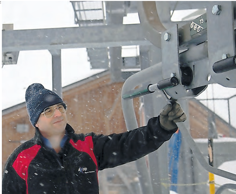
Certi lavori possono essere fatti solo a impianto fermo, di regola dopo la fine delle corse.
