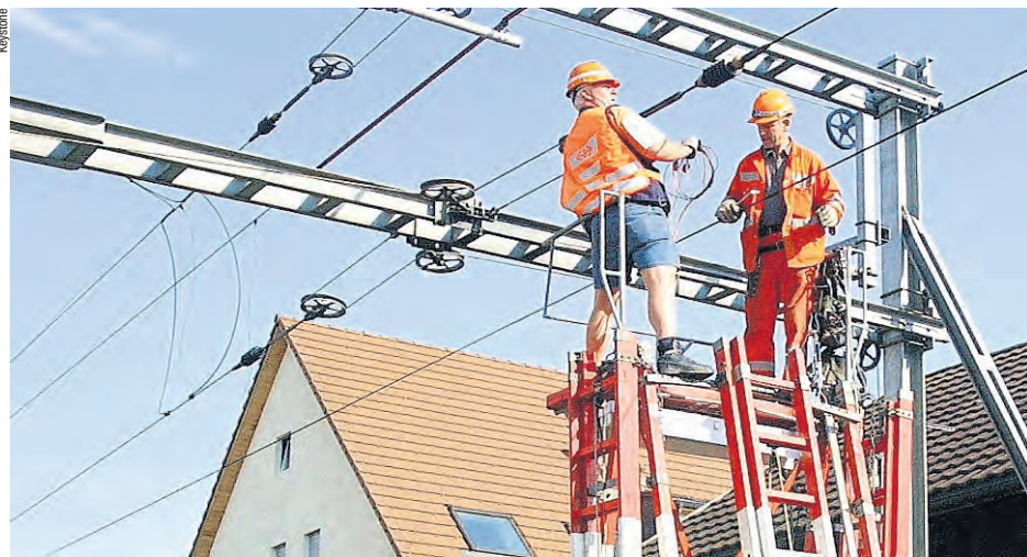
Lorsqu'il se passe quelque chose, il faut du renfort: par exemple lorsqu'une voiture touche les lignes de contact.
