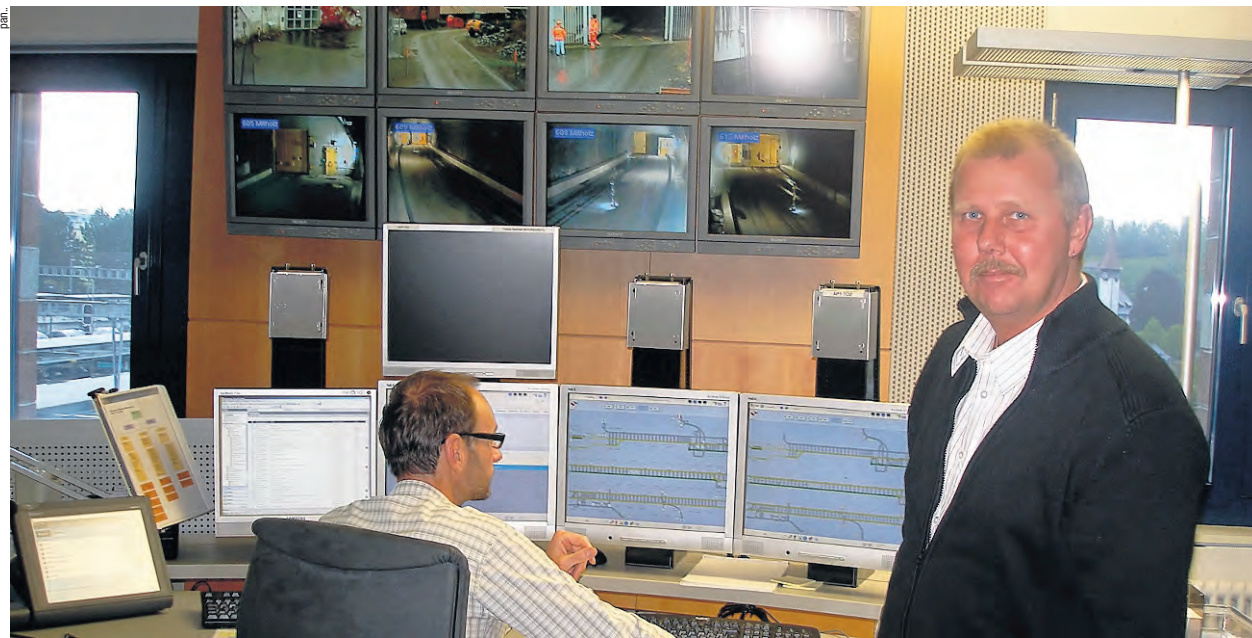
Franz Schmid devant un pupitre d'opérateur de tunnel. La situation dans le tunnel est contrôlée par ordinateur et écrans vidéo.
