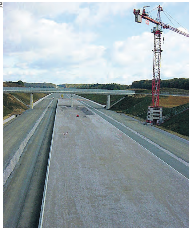
Sur le viaduc, la ligne classique Belfort-Bienne. Au-dessous les travaux de construction de la ligne grande vitesse Rhin-Rhône où sera construite la gare TGV de Meroux.
