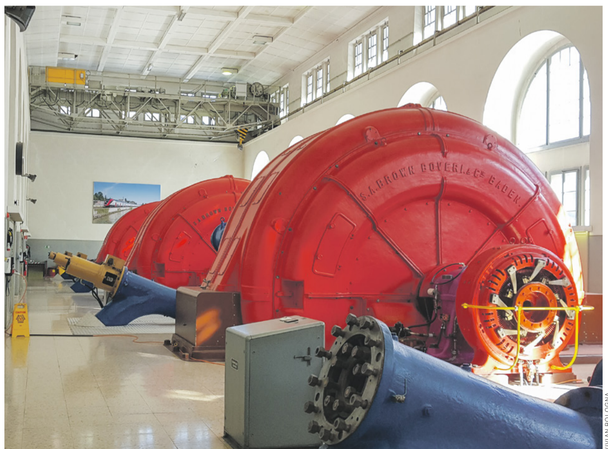
Im Kraftwerk Châtelard, stellen die Rotationsgeneratoren seit fast 100 Jahren die Verbindung zum Stromnetz der SBB mit 16,7-Hz-Bahnstrom sicher.
