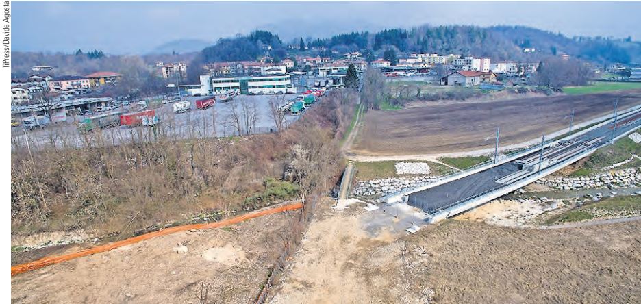
Stand der Linie Mendrisio–Varese im März 2016 an der Grenze bei Stabio: Links in Italien waren noch keine Schienen verlegt, während auf der Schweizer Seite die Linie vor der Grenze endete. Seit Dezember 2014 fahren ab Stabio S-Bahn-Züge Richtung Mendrisio, von Montag bis Samstag halbstündlich.
